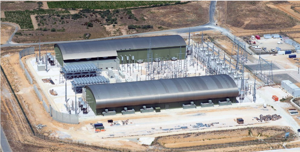
Transformazio-estazioa (Baixas, Frantzia)
